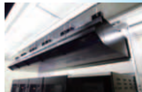
局所空調システム
