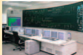
電力監視制御システム
