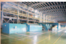
タービン発電機
