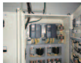
塗装工程のファンポンプ設備をインバータで効率運転
