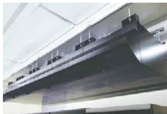
局所空調システム
