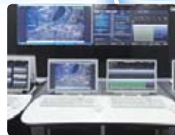
地域エネルギー管理システム
