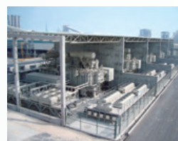
世界最大級のアルミ製錬プラント向けに、大容量整流設備を納入 (アラブ首長国連邦 Emirates Aluminium社)
