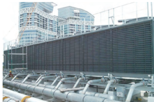
オフィスビルの屋上に設置されている空調システムの室外機
