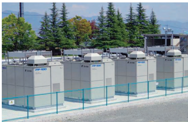
スマート化工場（山梨事業所）に設置された燃料電池
