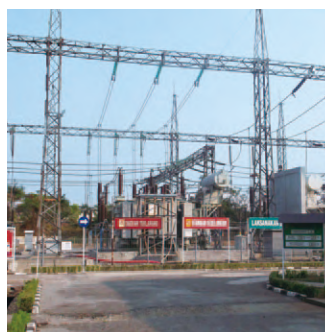
工業団地の受変電設備
