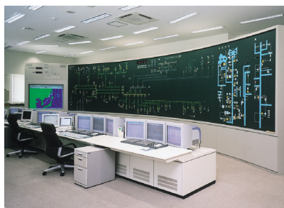
電力監視制御装置
