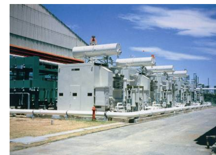
大容量整流設備
