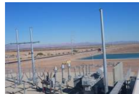
Hudson Ranch I 地熱発電所
