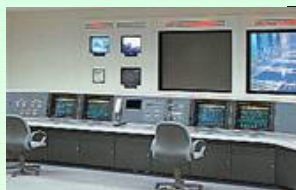
プラント制御システム
