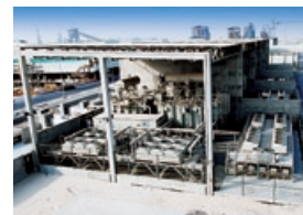
大容量アルミ電解用整流設備 (アラブ首長国連邦)
