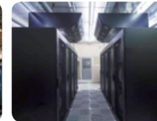
データセンター
