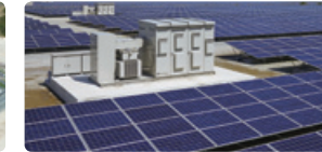
太陽光発電システム
