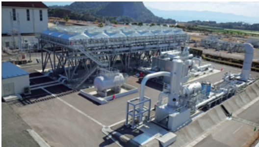
九電みらいエナジー株式会社様 山川バイナリー発電所
