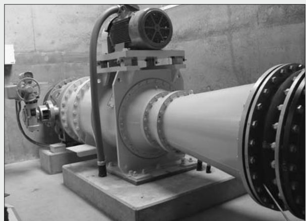
図7 マイクロ水力発電設備
