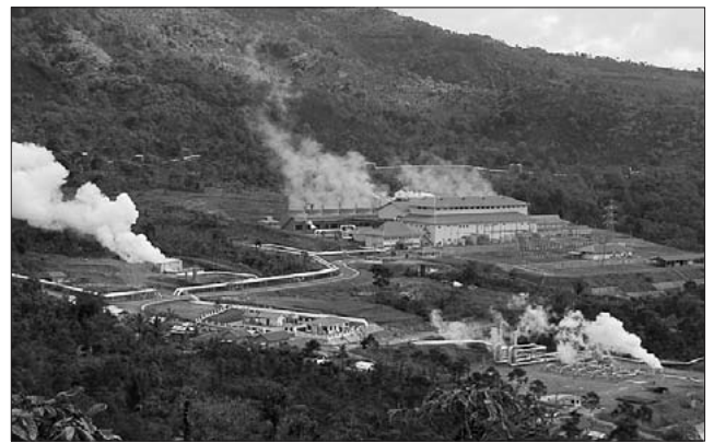
図7 ウルブル地熱発電所の全景
