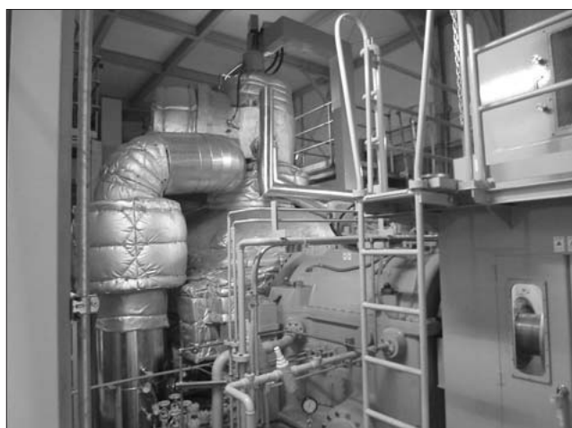
図1 吉の浦火力発電所向け蒸気タービン
