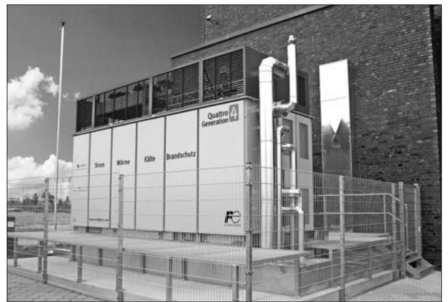
図 6 ヴィスマールに設置した燃料電池
