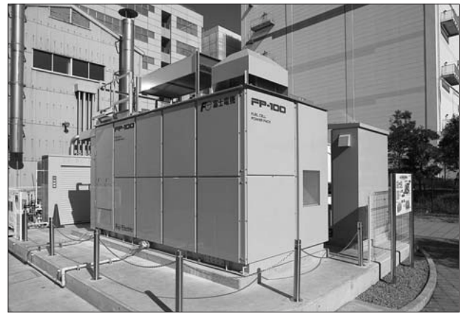
図3 富士電機川崎工場に設置した燃料電池
