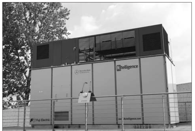
図 7 ハンブルクに設置した燃料電池
