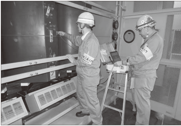
図6 モールド変圧器の診断の様子
