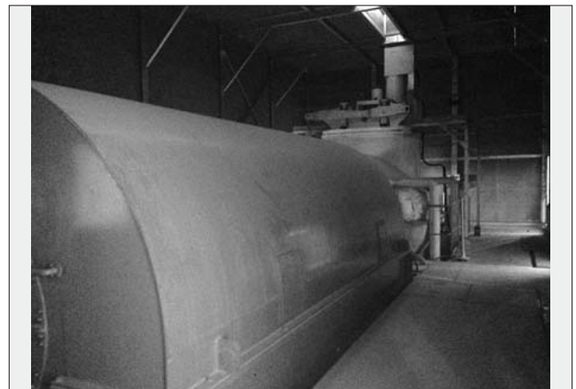
図3 蒸気タービン・発電機設備
