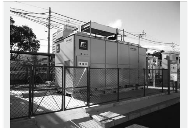
図8 三重工場に設置した燃料電池
