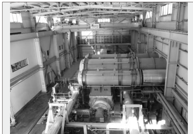
図4 クズルデレⅡ地熱発電所のタンデム式蒸気タービン
