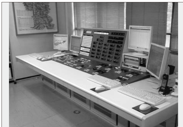
図1 ダム監視操作卓
