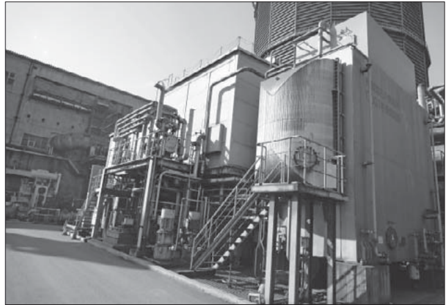
図4 CDQ1号蒸気タービン発電設備
