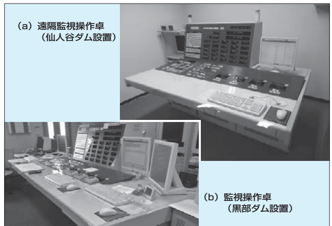
図5 遠隔監視操作卓（仙人谷ダム）と監視操作卓（黒部ダム）
