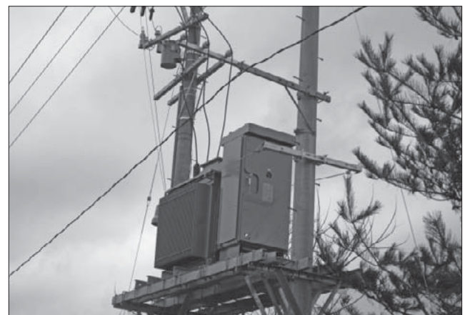
図9 配電用静止型無効電力補償装置
