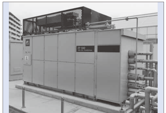
図8 東京工場に設置した燃料電池
