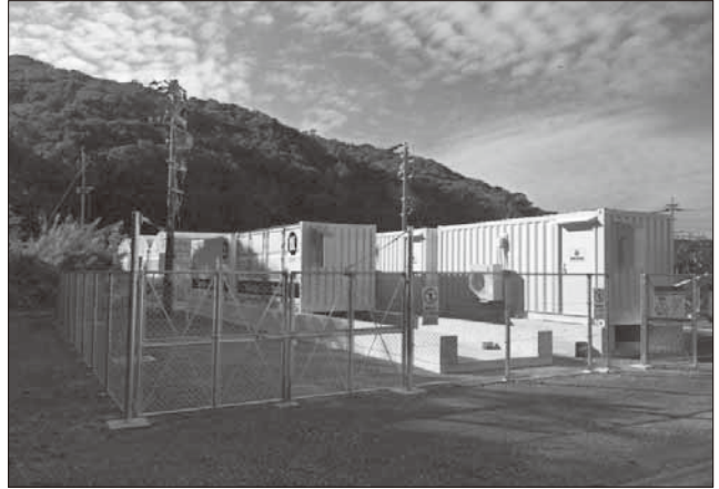
図4 甌島蓄電センターの外観
