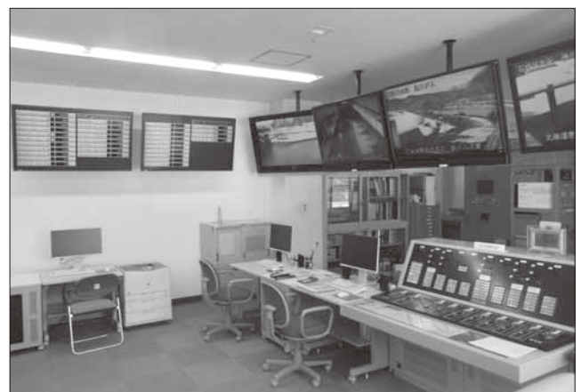
図3 漁川ダム管理支所のダム放流設備制御装置
