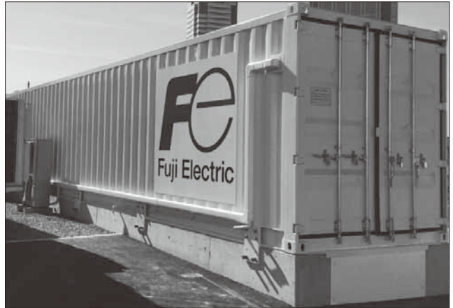
図5 大型リチウムイオン電池設備の外観
