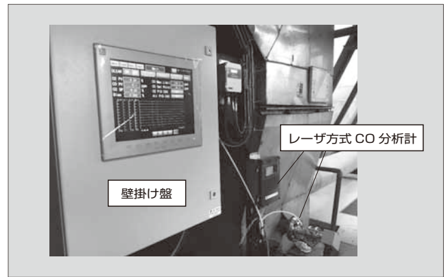
図6 壁掛け盤とレーザ方式 CO 分析計の設置状況
