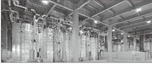
図7 南早来変電所の大型蓄電システム
