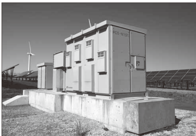
図4 PCS・昇圧変圧器・リングメインユニットの設置状況
