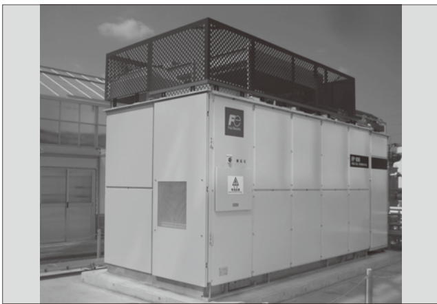
図3 東京工場に設置した燃料電池
