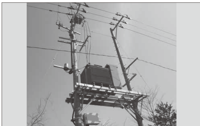
図7 フィールド試験における他励式配電系統用 SVC の設置状況
