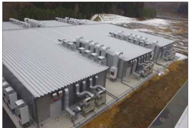
図11 株式会社IDC フロンティア向けモジュール型データセンターの外観
