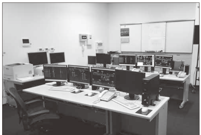
図6 電力管理システム（とやま指令所）
