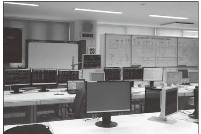
図7 電力管理システム（金沢指令所）
