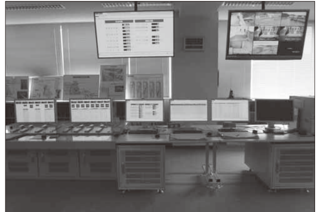
図1 ダム管理用制御処理設備
