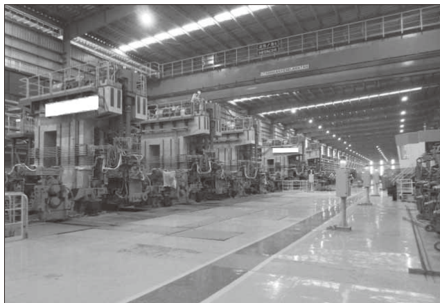
図 1 圧延設備の全景
