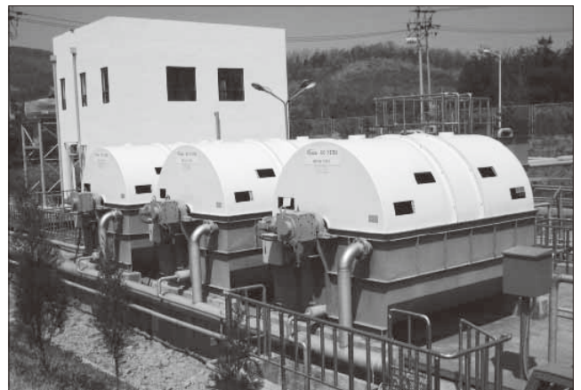
図3 回転円板装置の外観
