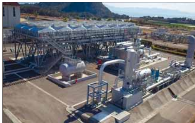
図9 バイナリー発電設備
