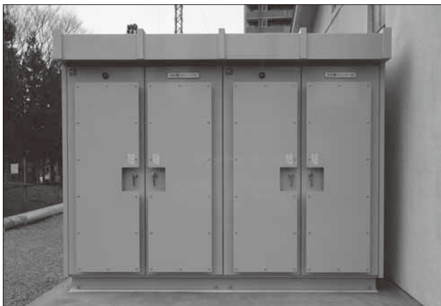
図4 吉田変電所向け電力回生吸収装置（インバータ）
