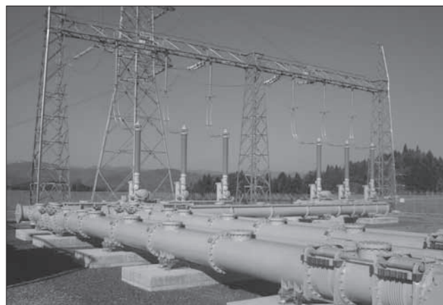
図1 変電所に納入した 300 kV 三相一括形 GIB
