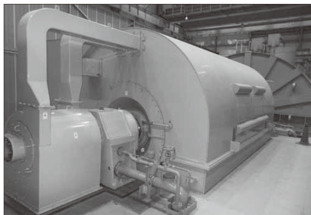
図3 名古屋第二発電所向け蒸気タービン・発電機
