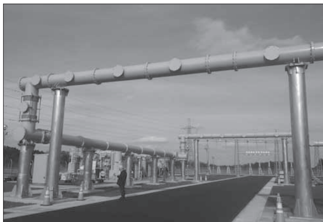
図 4 168 kV ガス絶縁母線
