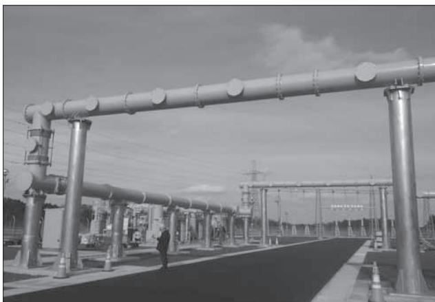
図 4 168 kV ガス絶縁母線
