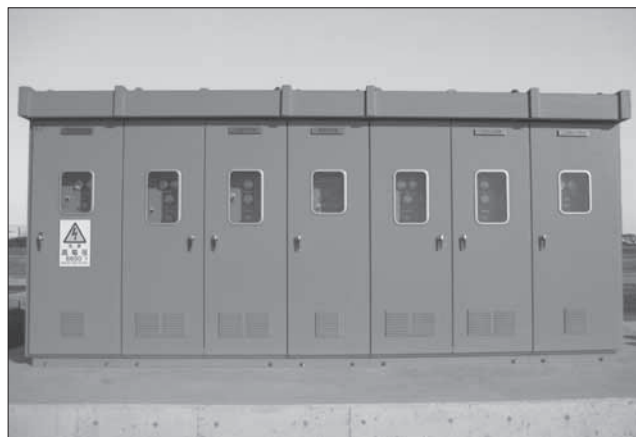
図7 屋外キュービクル式高圧受変電設備
