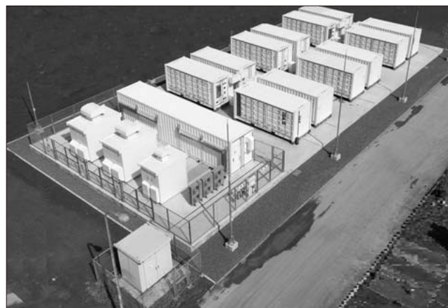
図 10 NAS 電池を用いた 2,400 kW 蓄電池 PCS
