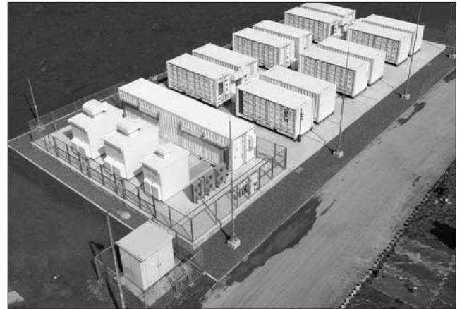
図 10 NAS 電池を用いた 2,400 kW 蓄電池 PCS
