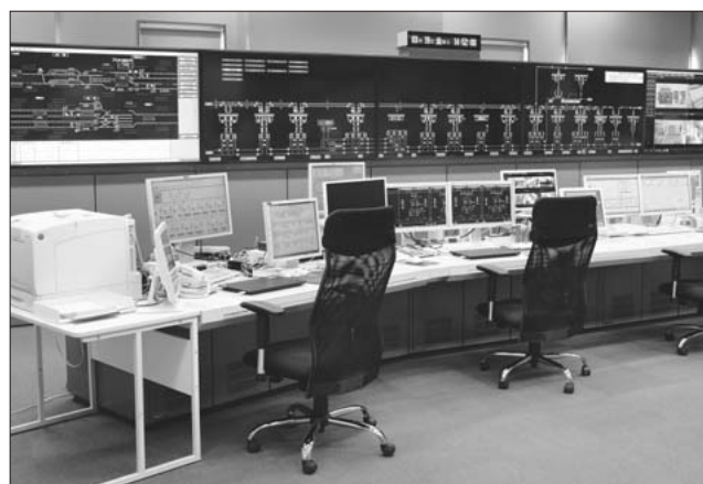
図5 電力管理システム（電気指令室）
