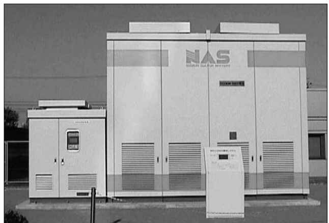
図4 500 kW NAS 電池電力貯蔵システムの外観
