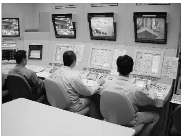
図 10 燃料取扱設備主制御監視盤
