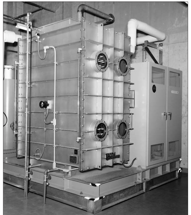
図2 中宮浄水場高度浄水施設オゾン発生装置
