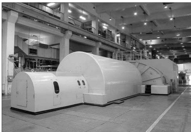
図 1 再生発電ユニットの全景
