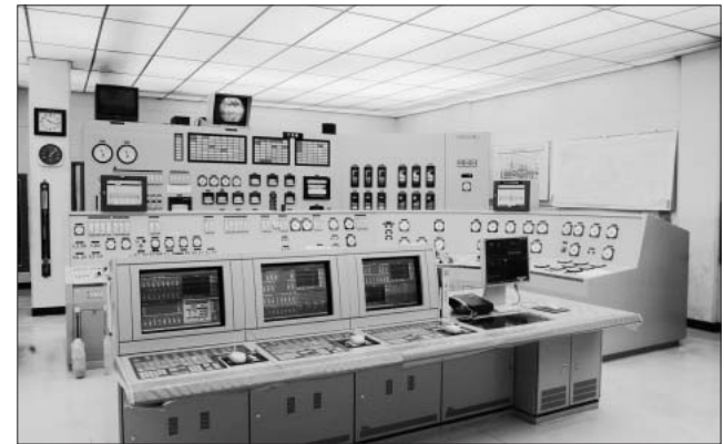
図10 更新後の中央操作室
