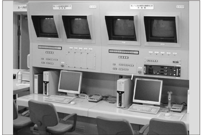
図5 制御盤の外観
