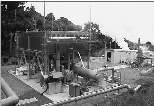
図4 地熱バイナリー発電設備
