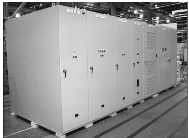
図8 高圧大容量瞬低対策装置の外観（本体）
