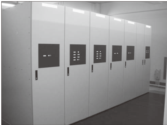
図7 直流高速度遮断器
