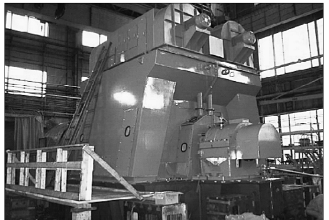
図 12 圧延主機用同期電動機の例
